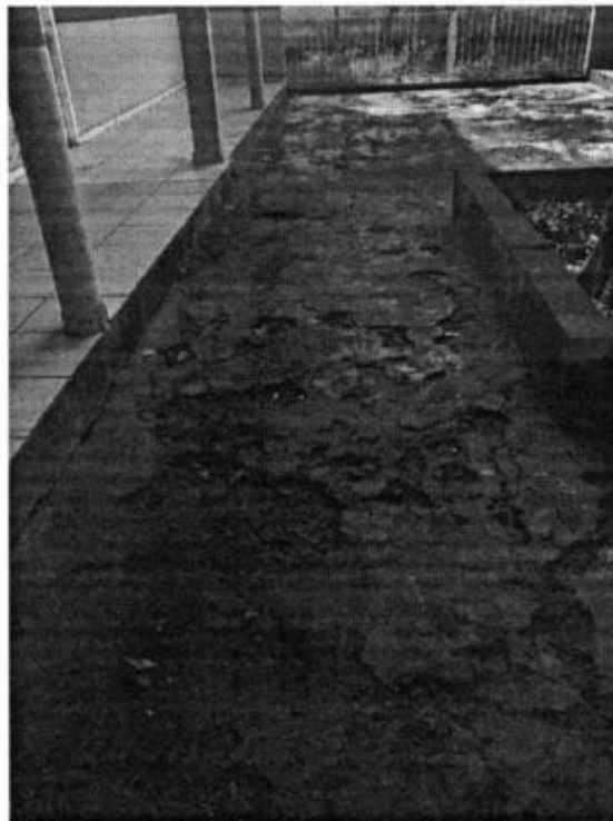
Piso em concreto a recuperar
