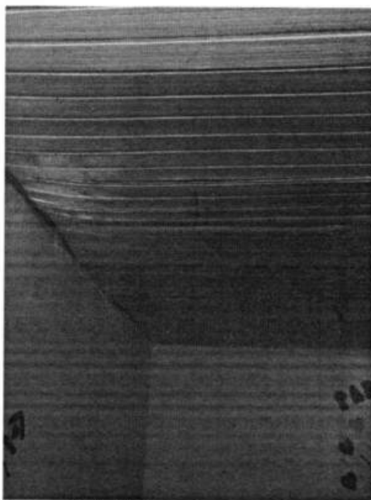
Forro a Substituir
