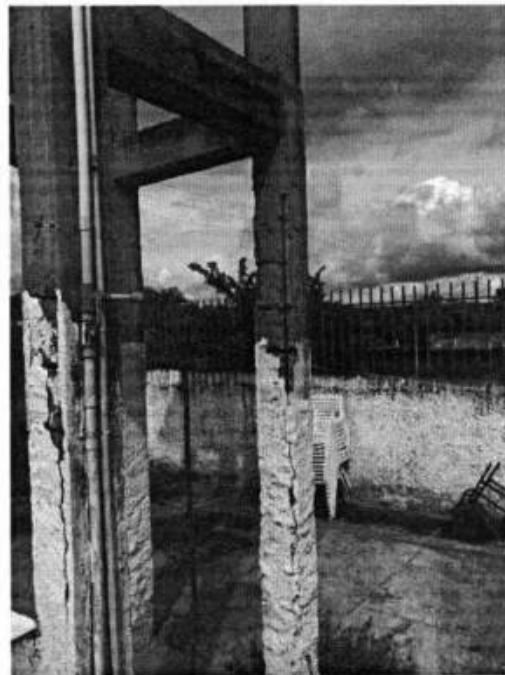
Estrutura da Caixa D'água a recuperar
