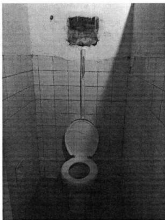
Banheiro – Bacia Sanitária sem Caixa de descarga
